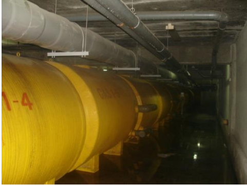
Tòa nhà Pacific, Hanoi 35 bể FRP
